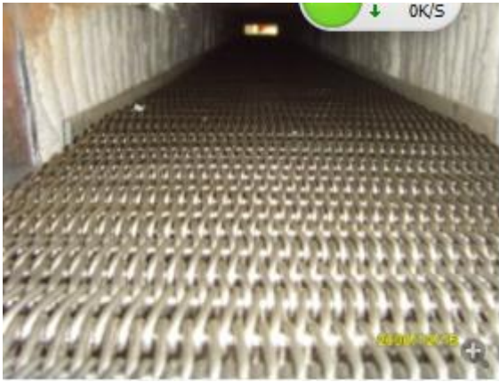
网带烧结炉内景
