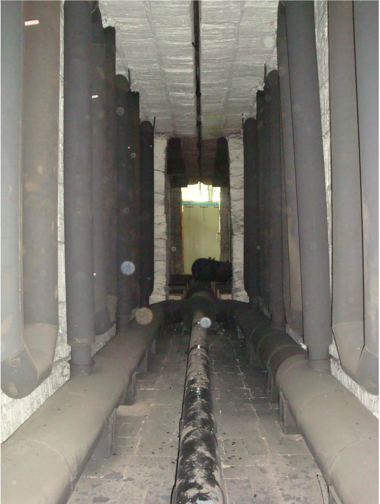
燃气辐射管实景
